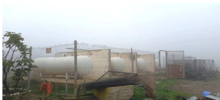
Figure 11: Vue de profil de 4 citernes à gaz (photo personnelle)
