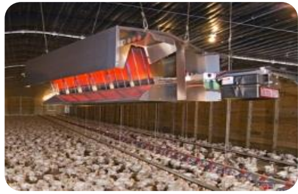
Figure 4 : Chauffage par Des radiants à gaz.
