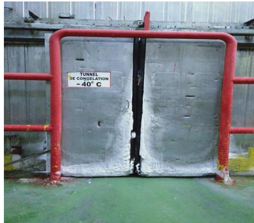
Photo 40 : Tunnel de congélation -40°C.
