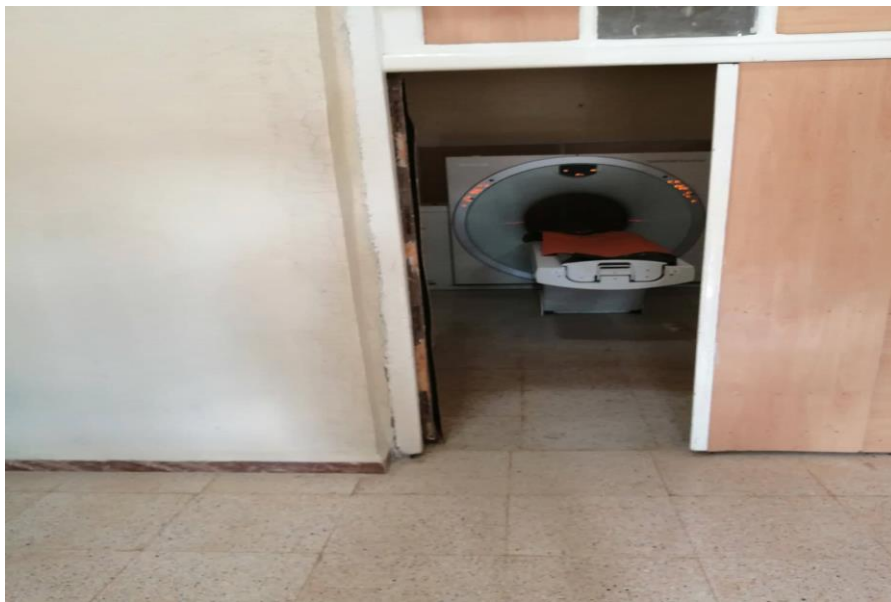
Figure n° 11 : la salle de scanner de CHV.
