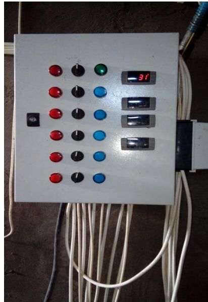
Figure n° 3 : Armoire régulateur thermique
