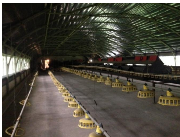
Figure 14 : Bâtiment après la 1 ère désinfection
