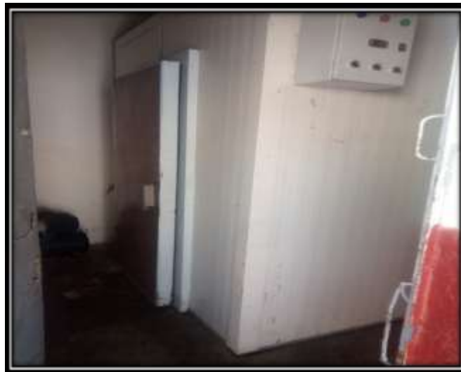
Figure 4 : Chambre froide à l'intérieur de la salle d'abattage (Photo personnelle ,2019).
